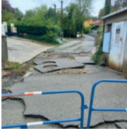
Chemin des Combes détruit
